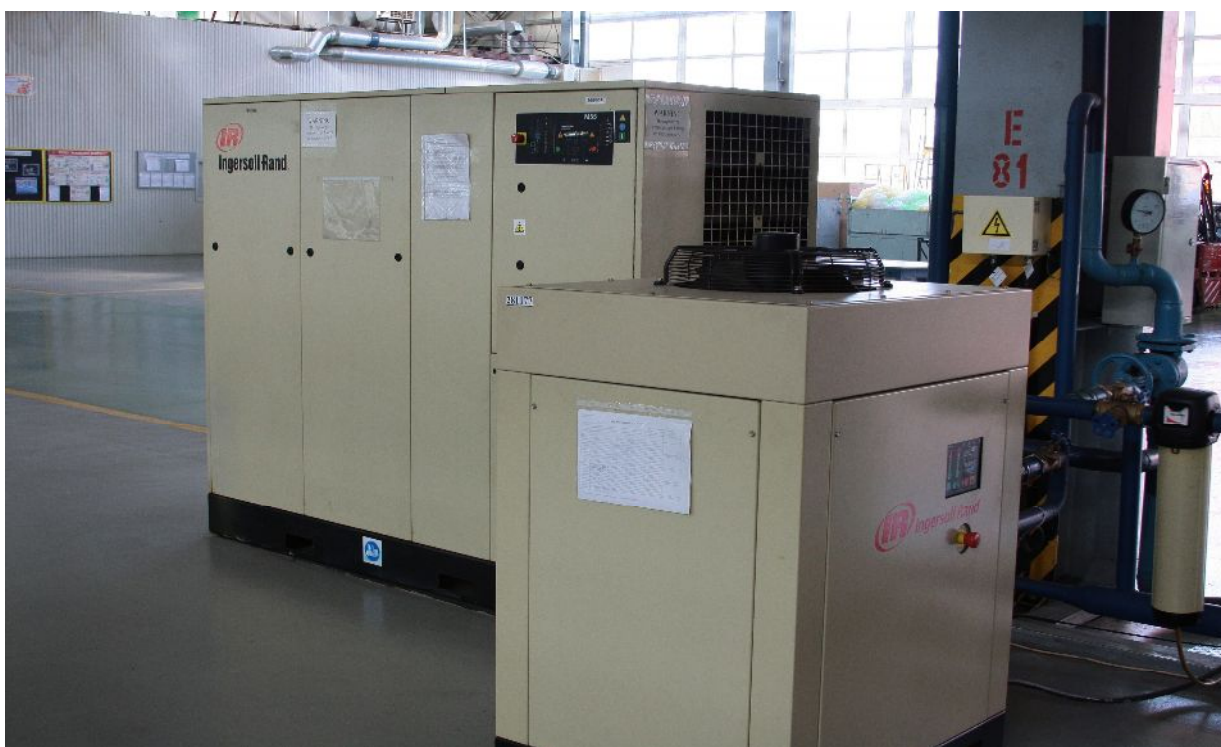
Рис.3 Локальный компрессор и осушитель сжатого воздуха в цехе сборки
